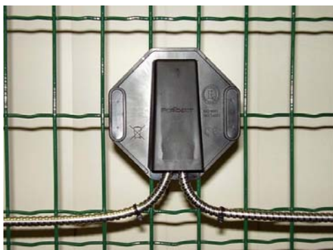
Датчик в антивандальном исполнении, кабель защищен металлорукавом из нержавеющей стали
